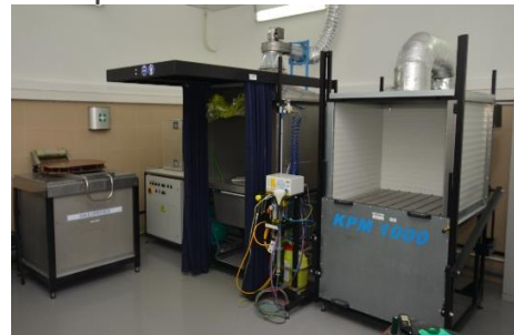
Участок неразрушающего контроля
