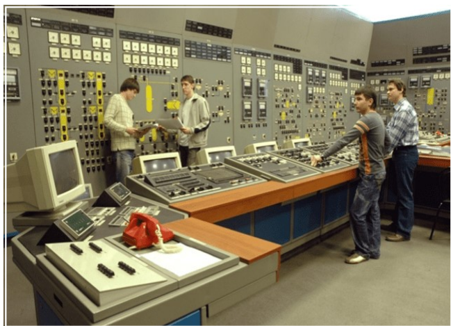
Полномасштабный тренажер управления энергоблоком АЭС с ВВЭР-1000
